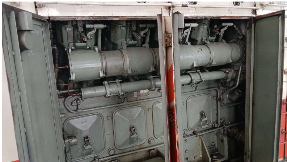
Gambar 1. 1 Sistem Pembersih Filter Udara pada Mesin Diesel Lokomotif
